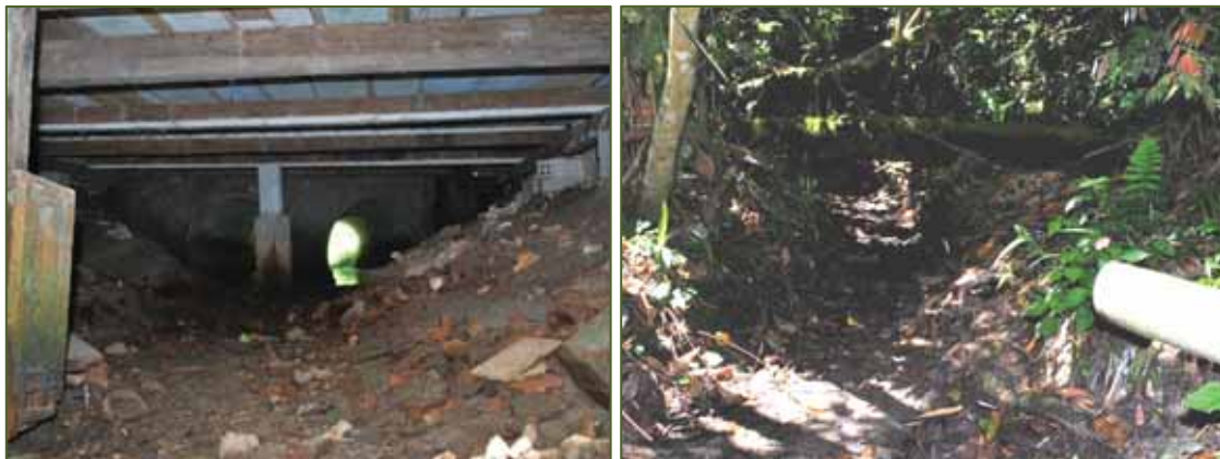
Figura 6-69: Dreno de escoamento pluvial descartado no terreno da Melport.
