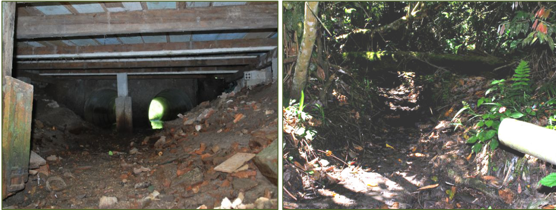
Figura 4-14: Dreno de escoamento pluvial descartado no terreno da Melport.
