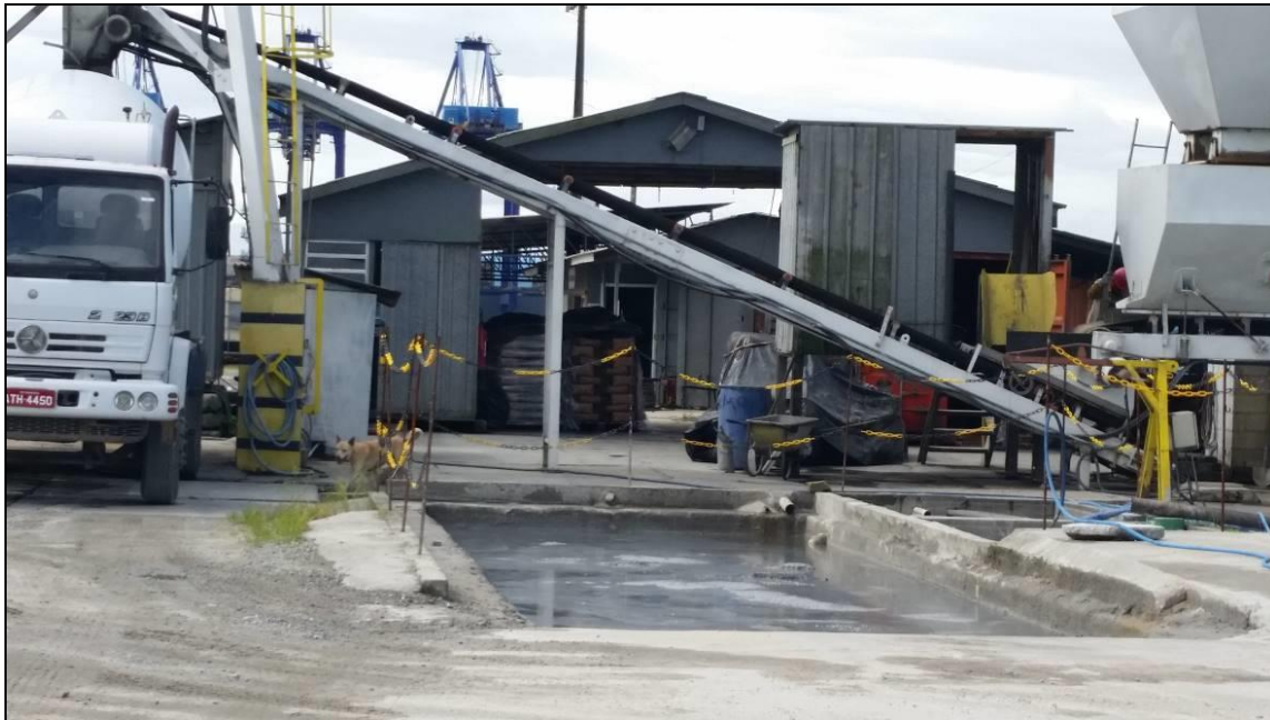
Figura 58. Vista da rampa usada para lavagem de caminhões betoneiras.
