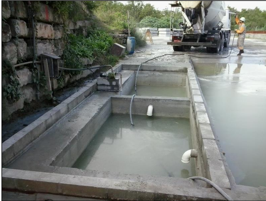
Figura 69. Caixas separadoras instaladas no sistema da usina de concreto.
