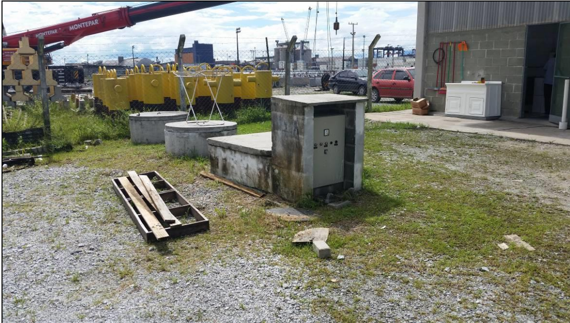
Figura 60. Estação de recalque.
