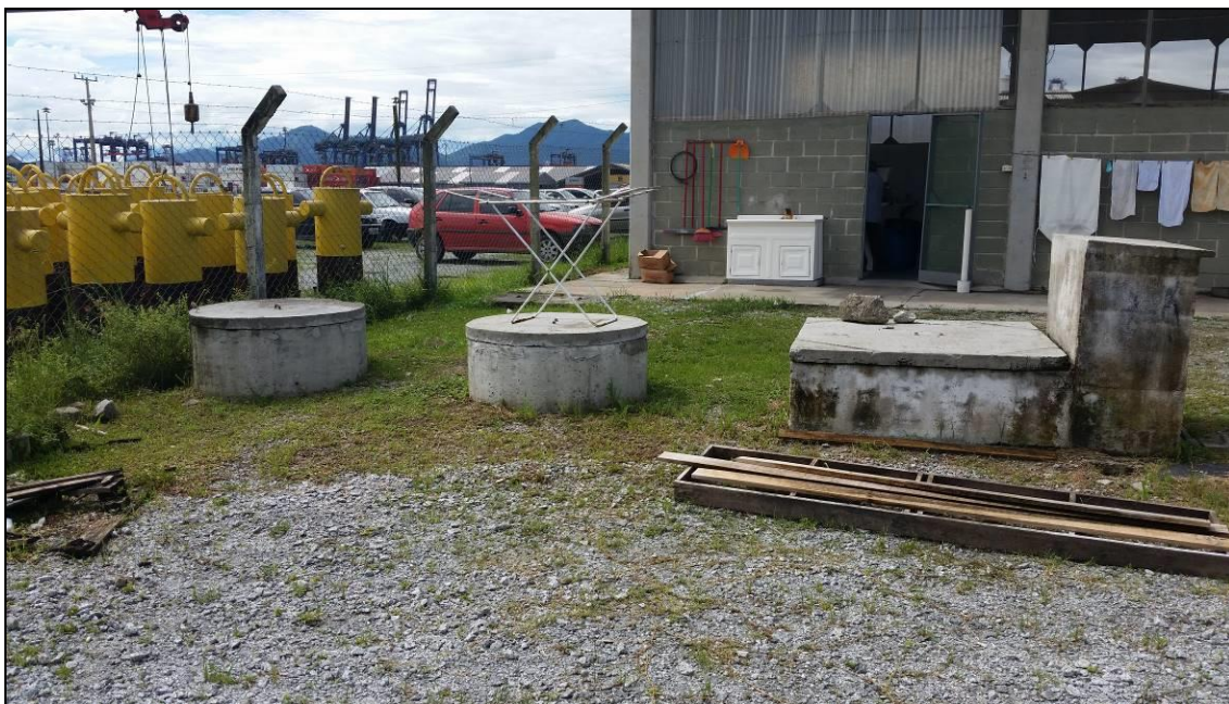
Figura 67. Caixas retentoras de gordura para onde são direcionados efluentes do refeitório.
