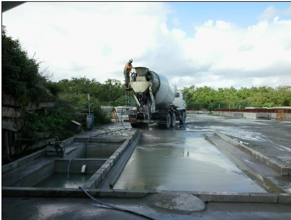
Figura 50. Sistema de tratamento de águas provenientes da produção de concreto.
