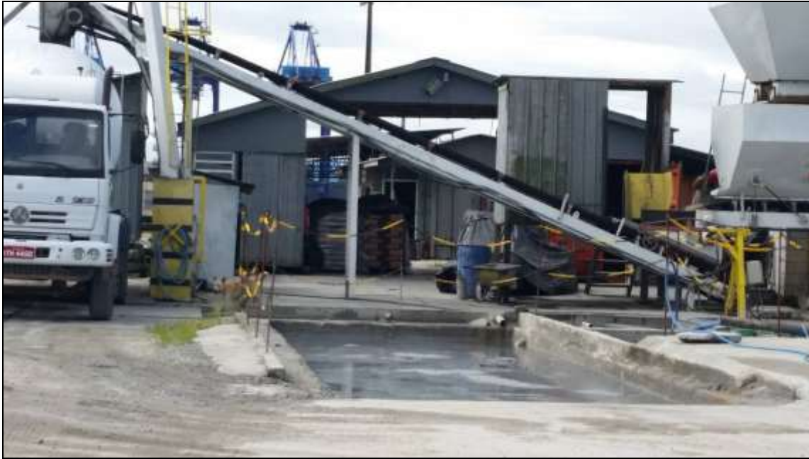
Figura 56. Vista da rampa usada para lavagem de caminhões betoneiras.
