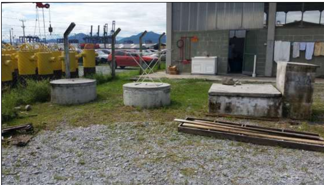
Figura 65. Caixas retentoras de gordura para onde são direcionados efluentes do refeitório.
