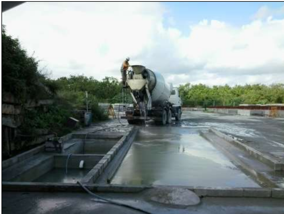
Figura 48. Sistema de tratamento de águas provenientes da produção de concreto.
