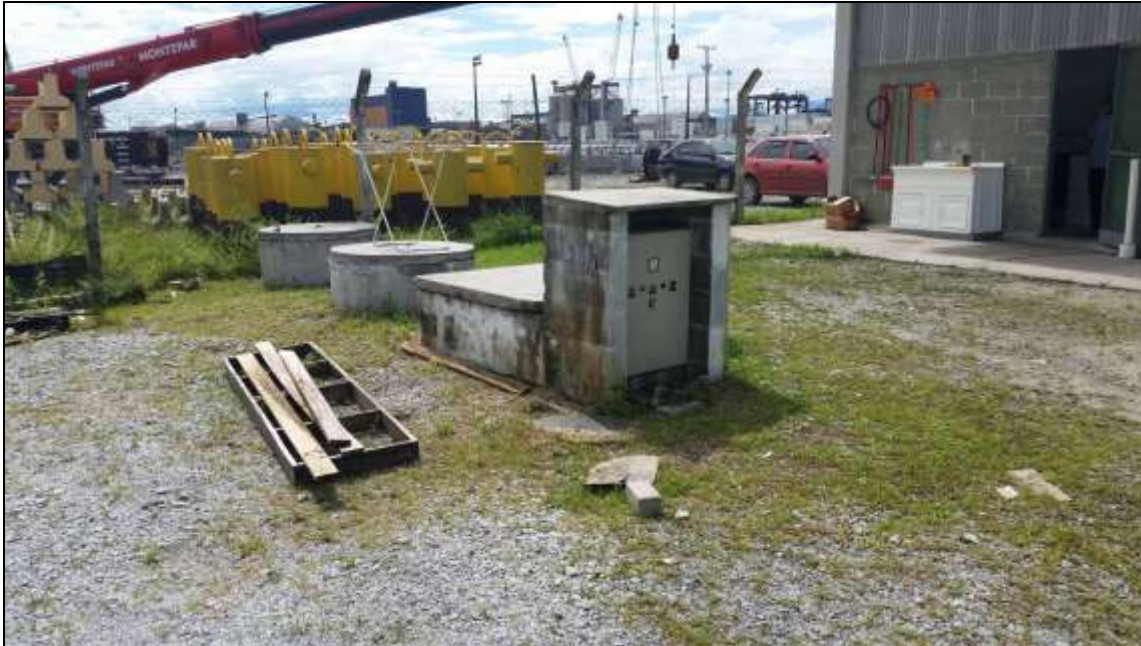
Figura 58. Estação de recalque.
