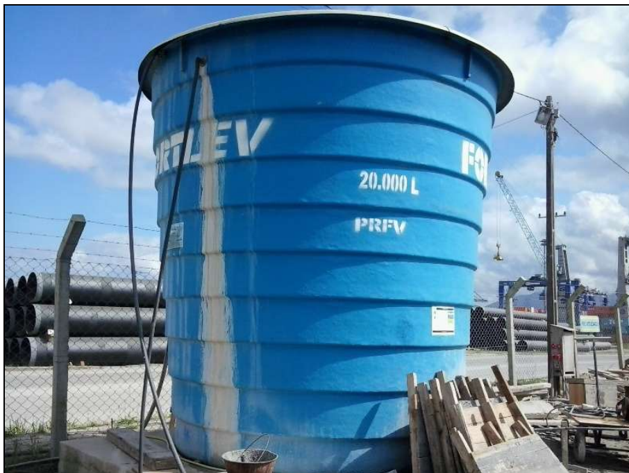
Figura 66. Tanque que será utilizado no canteiro de obras do TCP para armazenamento de água a ser reaproveitada na usina de concreto.
