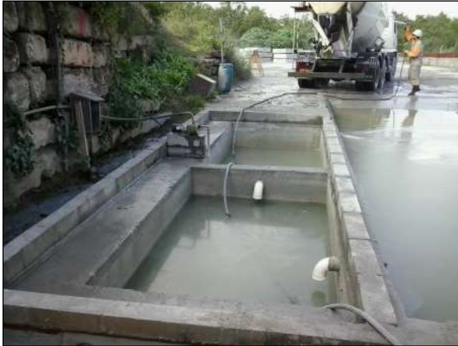
Figura 67. Caixas separadoras instaladas no sistema da usina de concreto.
