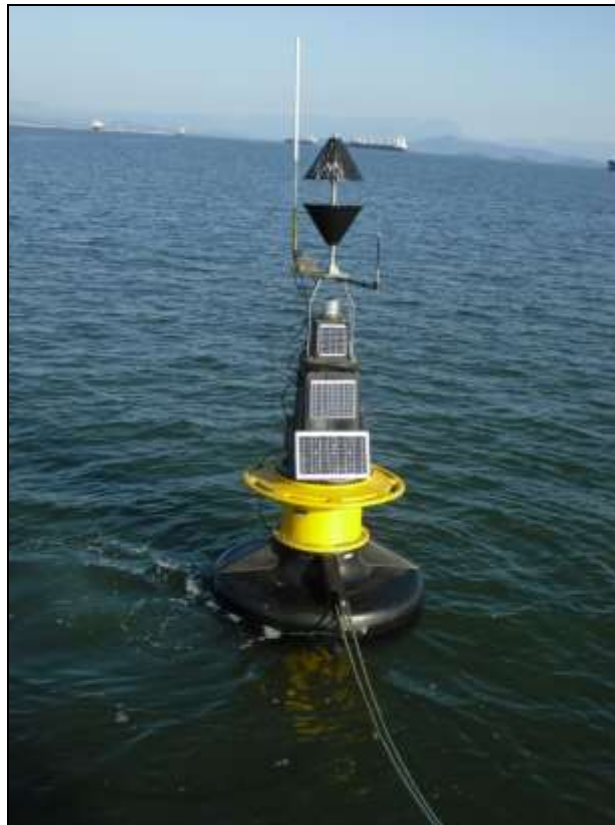
Figura 178. Detalhe da boia aonde está instalado o perfilador de correntes acústico AWAC®.
