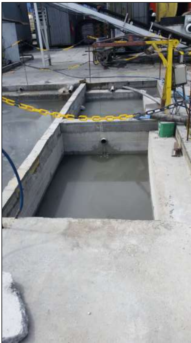
Figura 55. Caixas decantadoras de água e areia.
