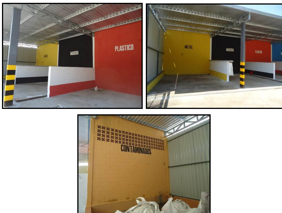
Figura 9 – Central de resíduos com baias para armazenamento interno temporário (recicláveis e resíduos contaminados).
