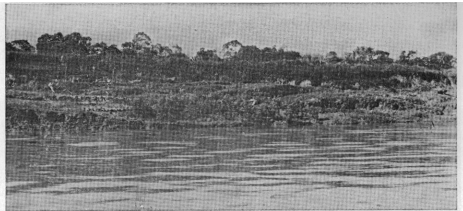
Fig. 8 – Deslizamentos causados pelas variações de vazão. Rio Muru, Tarauacá, Acre.
