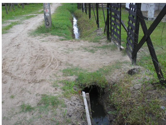
Foto 41 - Esgoto a céu aberto
