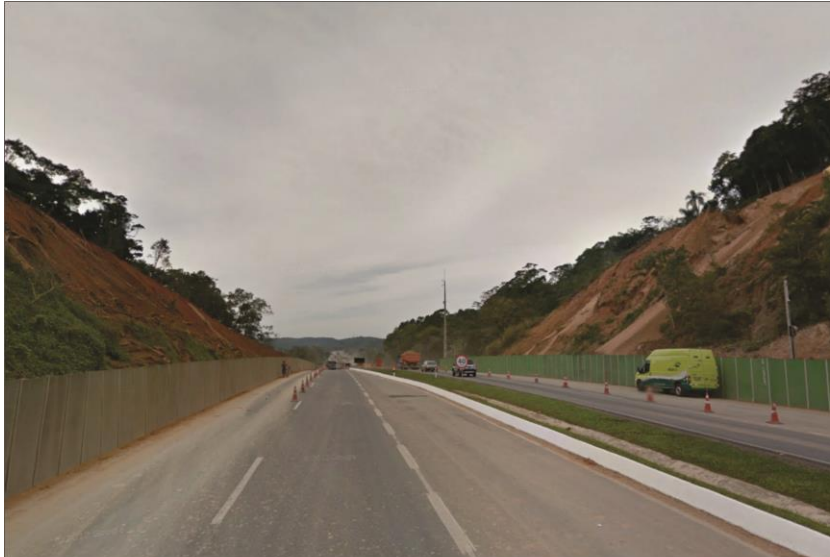
Figura 141. Área afetada por deslizamento de terra – Km 25 BR-277
