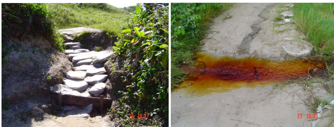
Figura 9 Erosão e Alagamento dos Caminhos
