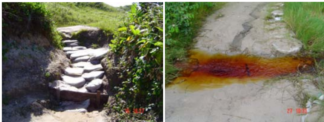
Figura 9 Erosão e Alagamento dos Caminhos
