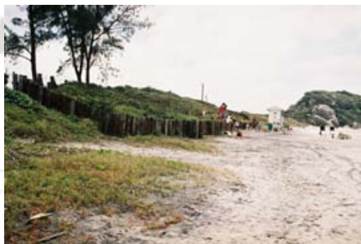
Figura 43 Muro vertical longitudinal à praia construído com troncos (palçada) na praia de Fora do Farol das Conchas.
