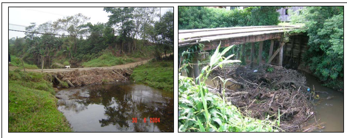
Figura 65: entulhamento de galhos e arbustos em pontes após enxurrada, ocasionando transtornos para os procedimentos de medição de vazões. Fotos: F.A.Oliveira, 2004.
